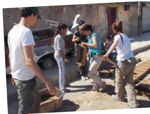
2015 hat sie als Mitglied einer Solidaritätsbrigade der ICOR ein Gesundheitszentrum mit aufgebaut, im Bild bei der Lehmziegelproduktion
